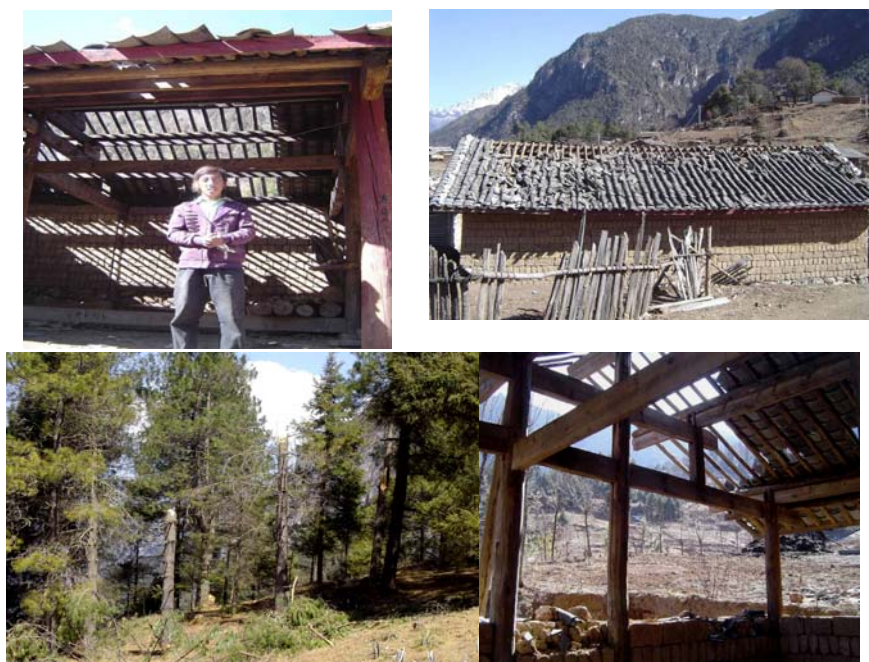
图解：房屋不同程度受到损害
